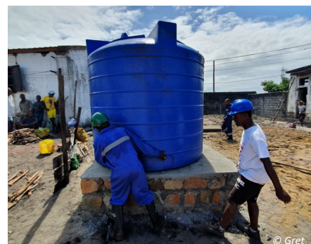
Mise en place d'un réservoir d'eau dans la maison centrale de Mananjary, novembre 2022
