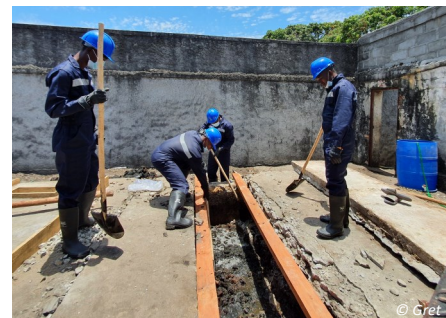
Assainissement dans la maison centrale de Manakara
